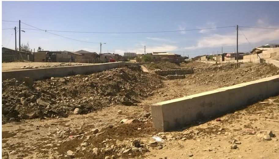
Fotografía 8. Quebrada menor en las partes urbanas periféricas de Huasco, en la cual se han realizado medidas de mitigación de flujos aluvionales.
